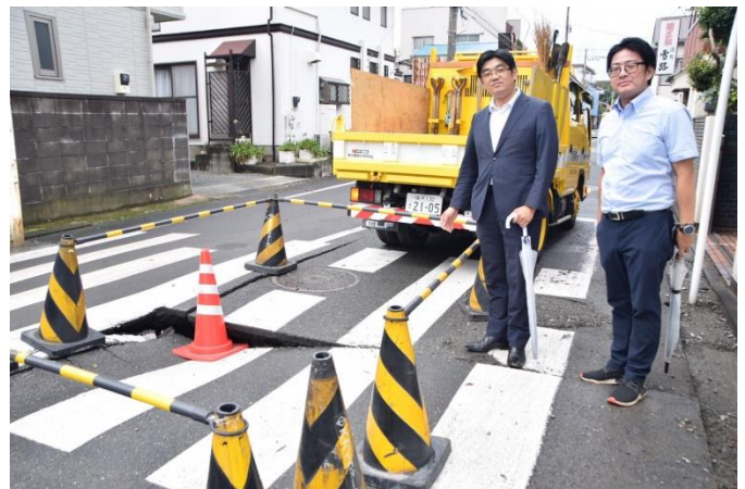
陥没した道路
